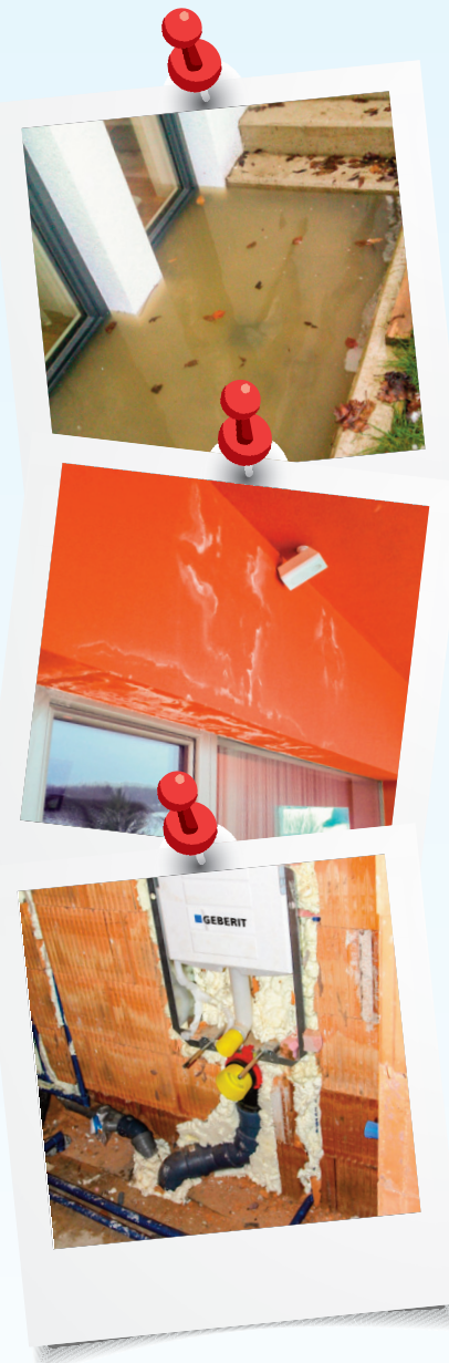
Fotos aus der Praxis von Günther Nussbaum: Aufgestautes Wasser vor dem Kellerfenster, Wasserschaden an der Fassade und unsachgemäße Abdichtung des Mauerwerks bei Installateurarbeiten
