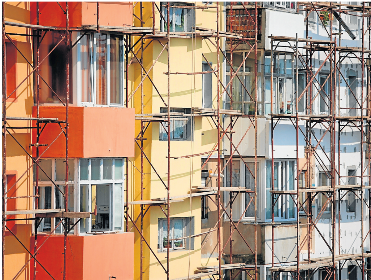
Noch neu und schon wieder Reparaturarbeiten fällig? Nicht alle Baumängel sind so offensichtlich.
